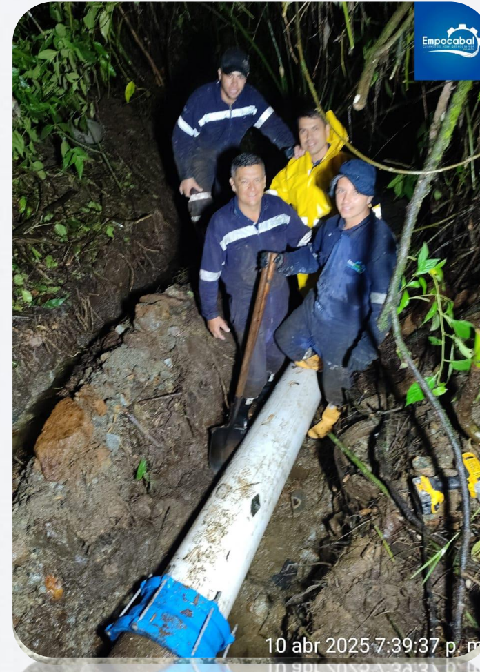
Afectación aducción No. 02
