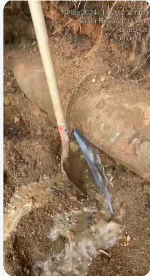
Afectación aducción No. 01
