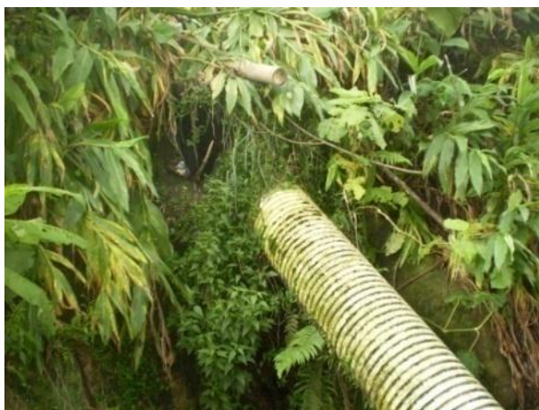
Foto1. Descole en viaducto
