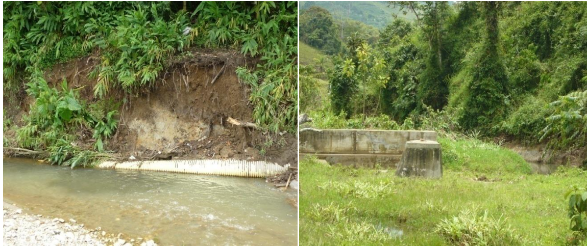
Socavación Interceptor Paralelo Tubería Novafort 24". Interceptor Q. San Roque. Conectado
