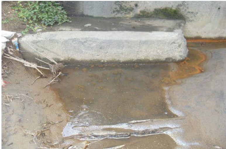
Vertimiento sobre la fuente
