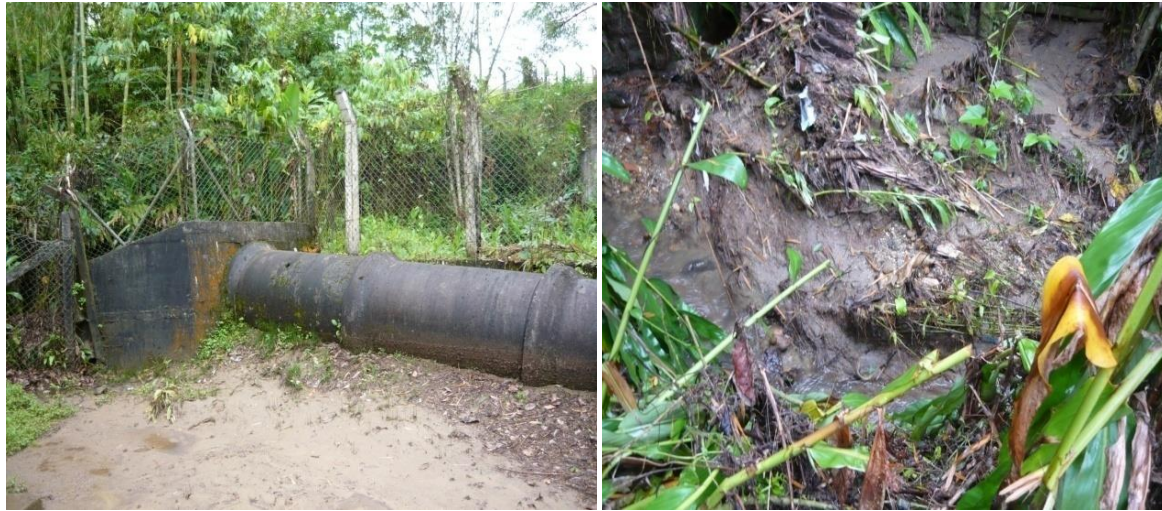
Colector pluvial barrio Monserrate, Quebrada Monserrate. Desbordamiento de la Quebrada por falta de conexión, material de avalancha.
