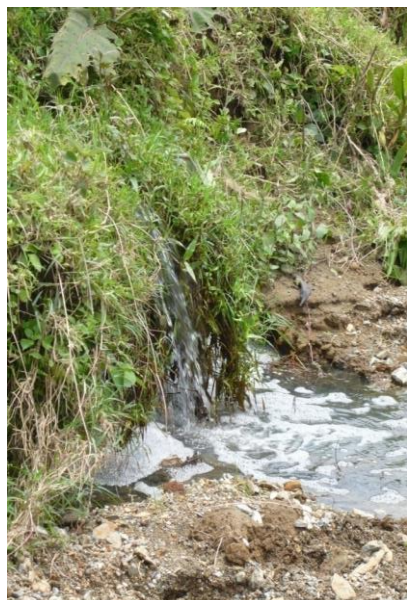
Vertimientos directos al lecho de quebrada por. taponamiento de cámara.
