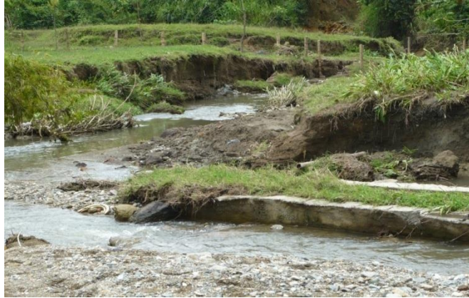
Quebrada San Roque. Cambio permanente de cauce.
