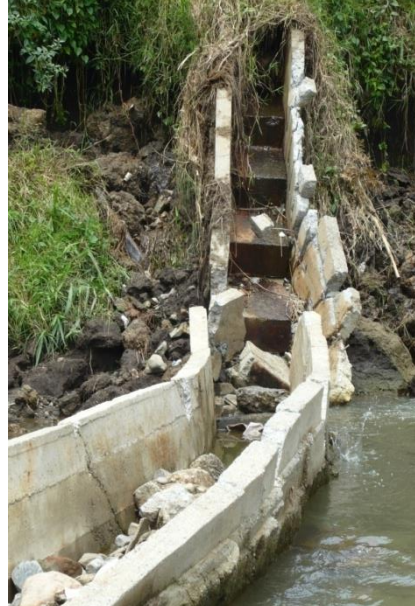
Deslizamiento de infraestructura de drenaje de aguas quebrada San Roque.
