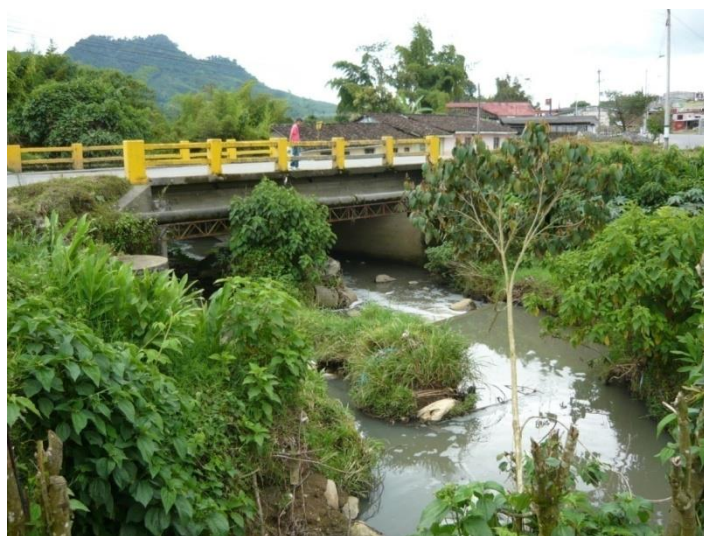
Cruce Barrio Manantial – Barrio El Palmar – Interceptor desconectado del sistema.
