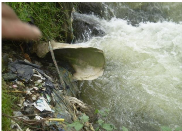
Foto 1. Río San Eugenio sector Plaza de Ferias (Descole de aguas taponado en mal estado) Presencia de residuos sólidos
