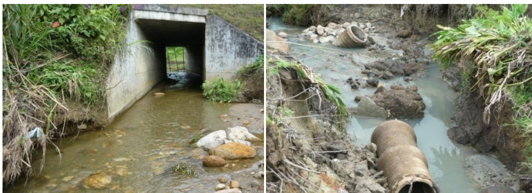
Quebrada San Roque. Cruce Autopista del Café Colector Los Portales. Colapso Tubería
