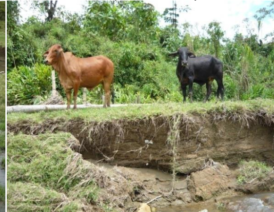
Q San Roque. Pastoreo en Perímetro Urbano sobre interceptor
