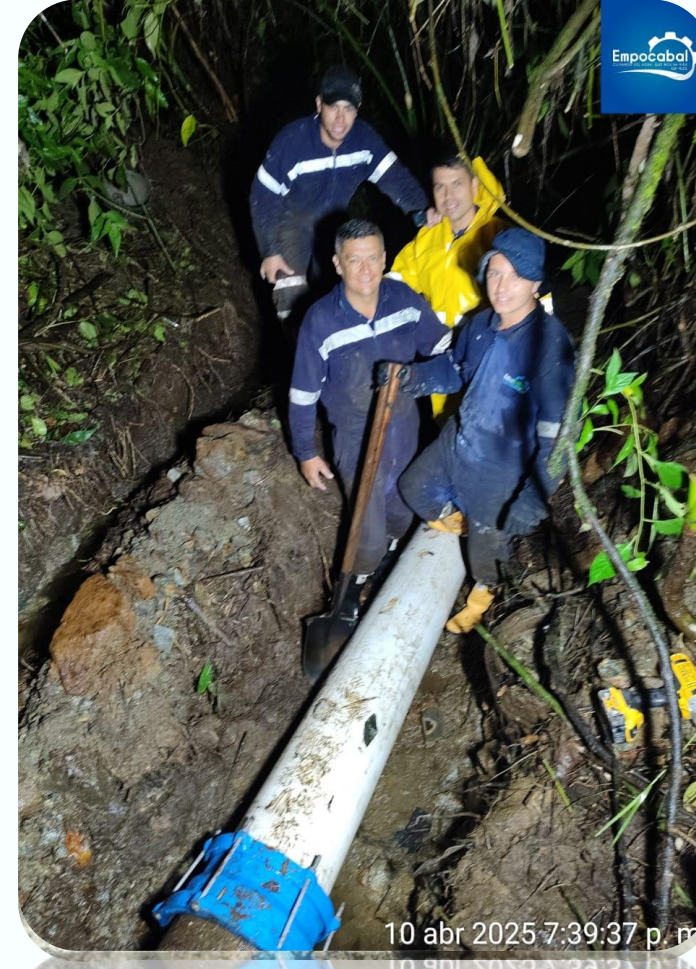
Afectación aducción No. 02
