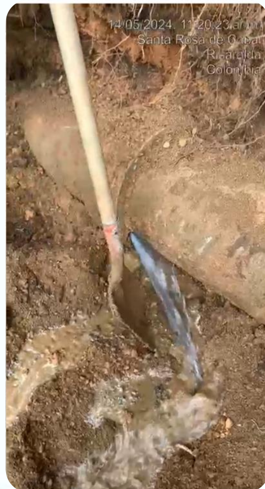
Afectación aducción No. 01
